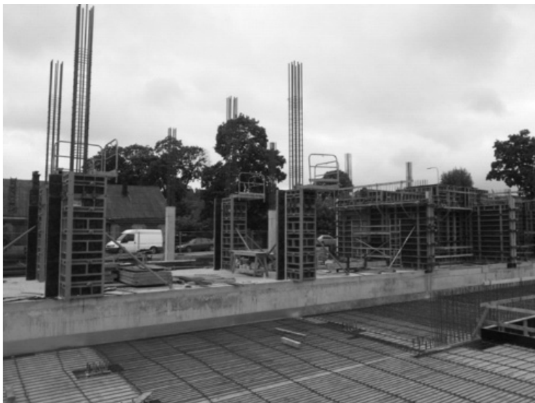
13 paveikslas. Gelžbetonio konstrukcijų įrengimas. Klojinių, armatūrinių strypynų montavimas laikomi paslėptais darbais, kuriems turi būti surašomi atitinkami aktai, nors statybos inžinerijos mokslo prasme šie darbai yra tik darbo (elemento, konstrukcijos) dalis ( nuotr. autoriaus )
